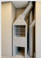
Sistema de exaustão semicoletivo
